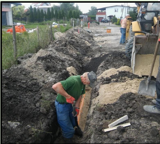
Budowa sieci kanalizacji sanitarnej w rejonie ulic Stobika, Wróblewskiego oraz Promnickiej o łącznej długości 766,00 mb.
